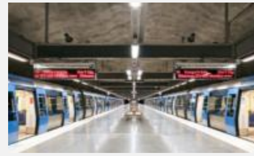
地铁车站公共照明
